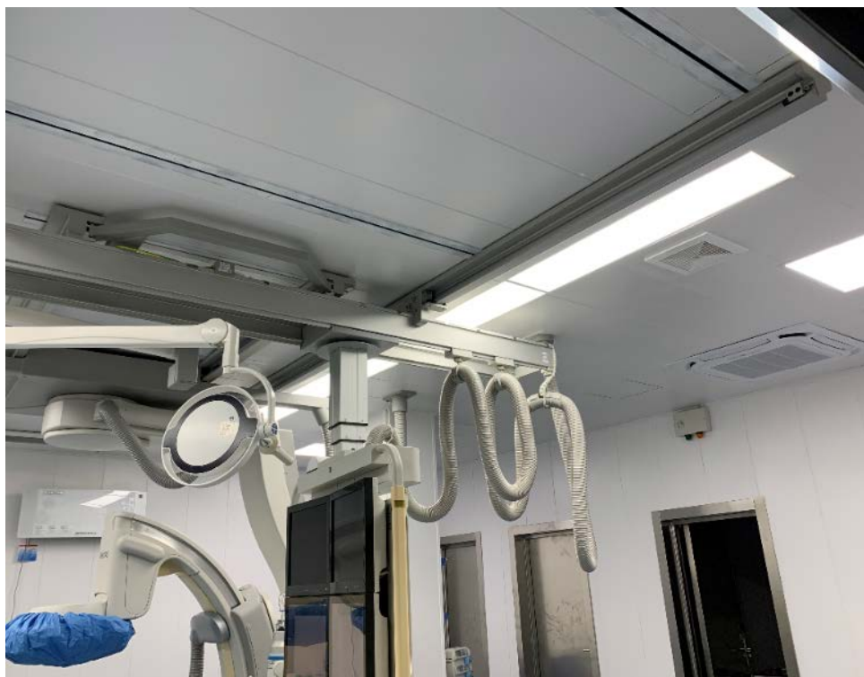
图 4-6 通风换气装置实物图
