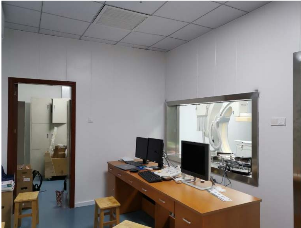
图 3-4 控制室现场照片
