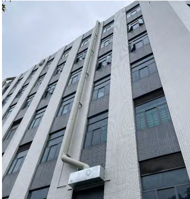
图 4-1 排风口现场照片
