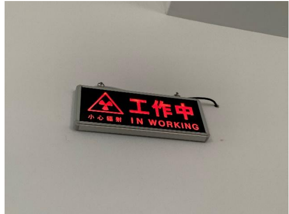
4-1.2CT 室门口警示标志
