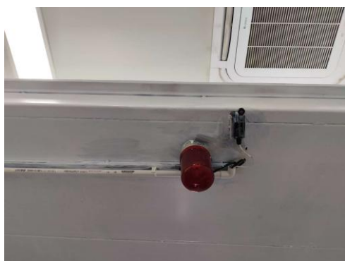
图 3-3.1 防护门门机联锁装置
