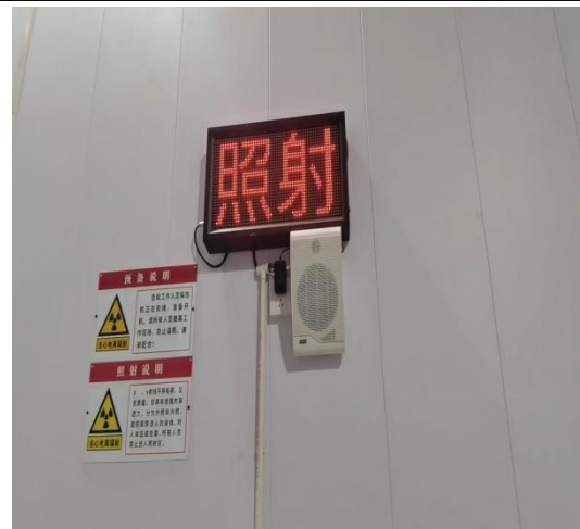
图 3-8 探伤室内部工作状态指示灯
