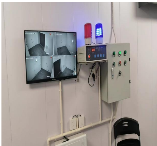
图 3-9 操作室内视频监控显示屏
