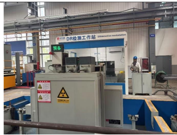
DR 探伤铅房设置电离辐射警告标志、预备照射工作状态指示灯及意义说明
