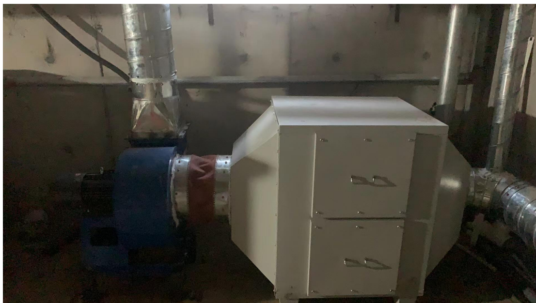
地下一层活性炭装置
